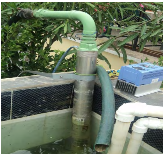
Fig. 14. Pompe centrifuge installé au CDER
