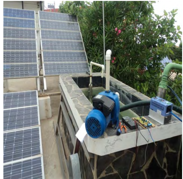
Fig. 14. Le système de pompage au niveau du CDER.
